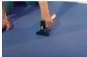
Пустоты под уложенным и притертым линолеумом можно "услышать", простукивая поверхность молотком.
